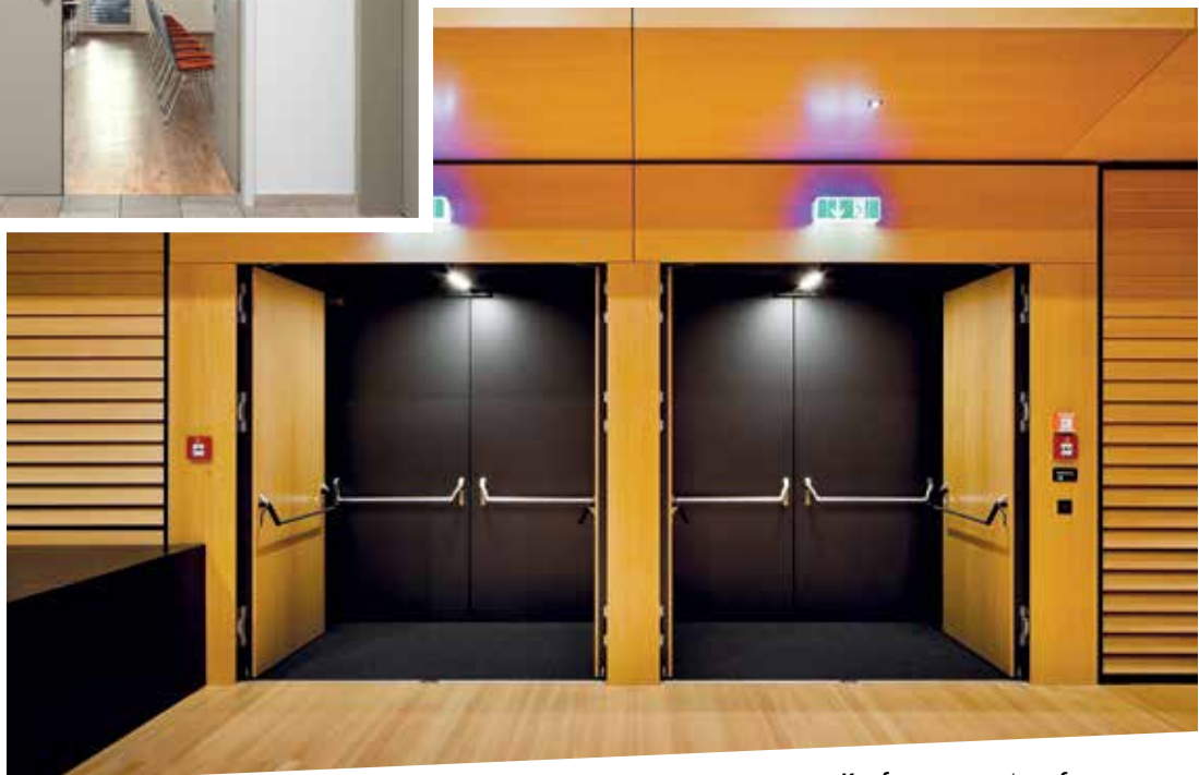
Konferenzraum / conference room Brandschutzelement T30-2-RS, Vollpanikfunktion fireproof element T30-2-RS, full panic function
